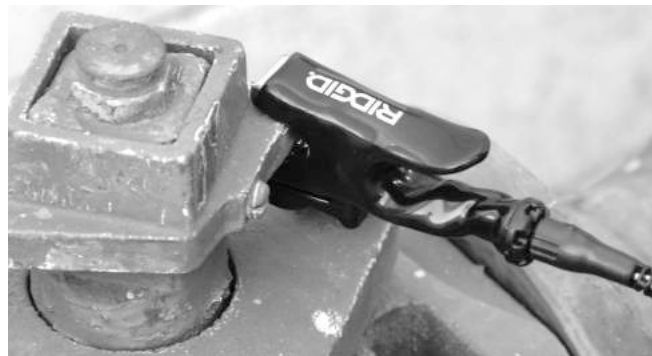
Рис. 8 – подсоединение провода кабеля к целевому проводнику
